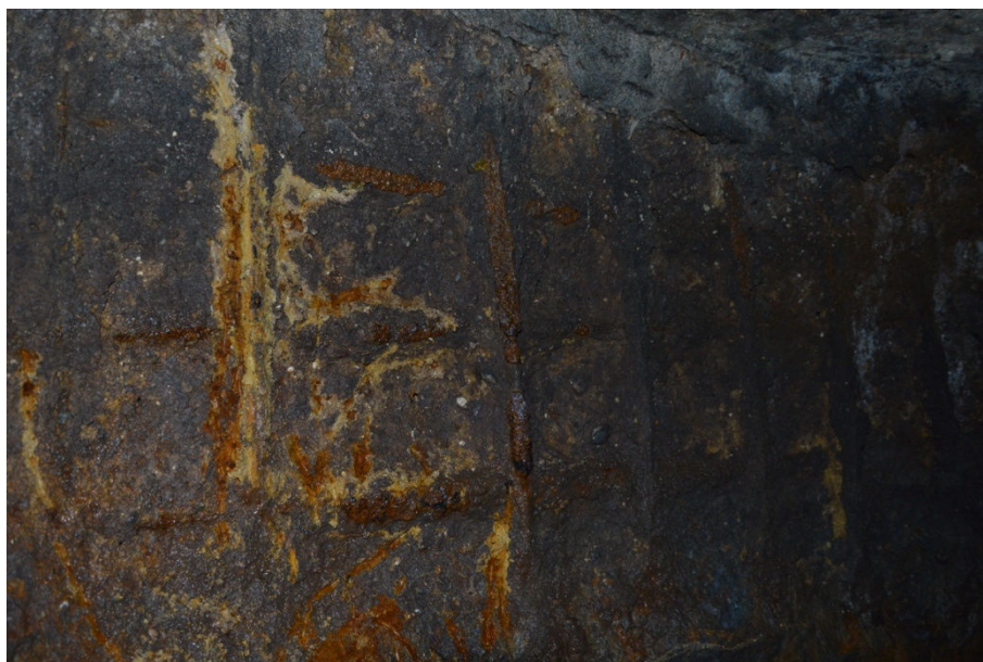
Fot. 1. Komora 1, odsłonięte i skorodowane zbrojenie ściany komory.
