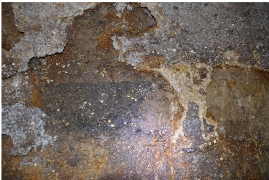
Fot. 4. Komora 2 korozja powierzchni betonowej.
