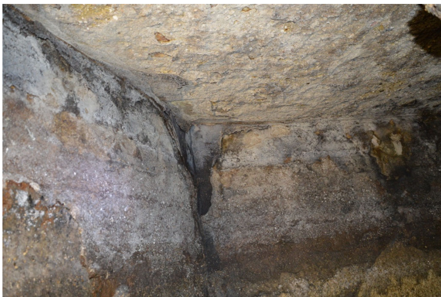
Fot. 3. Komora 2 resztki laminatu widoczne u zbiegu dwóch ścian i stropu.
