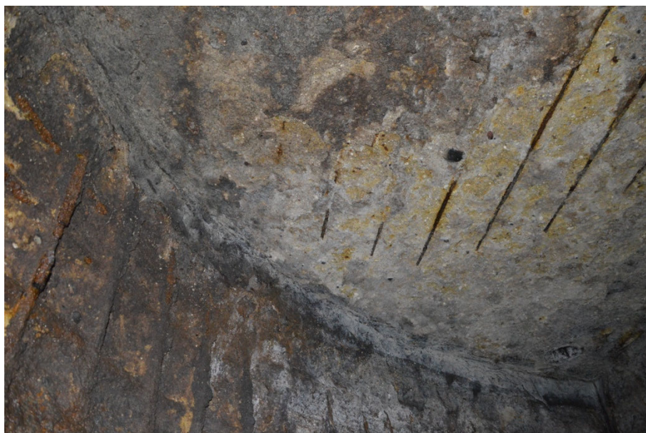
Fot. 2. Komora 1, odsłonięte i skorodowane zbrojenie stropu.
