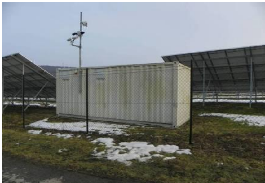
Fot. 3. Przykładowa kontenerowa stacja transformatorowa z urządzeniami sterującymi i monitorującymi, towarzysząca instalacji fotowoltaicznej - rejon miejscowości Tremesna, Republika Czeska [fot. Krzysztof Kręciproch]
