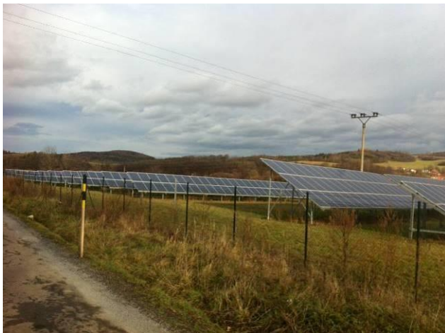
Fot. 1. Przykładowa naziemna instalacja fotowoltaiczna - rejon miejscowości Tremesna, Republika Czeska [fot. Krzysztof Kręciproch]
