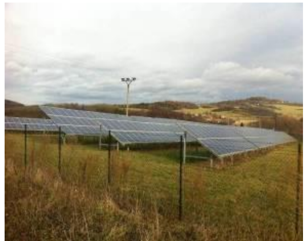
Fot. 2. Przykładowa naziemna instalacja fotowoltaiczna - rejon miejscowości Tremesna, Republika Czeska [fot. Krzysztof Kręciproch]
