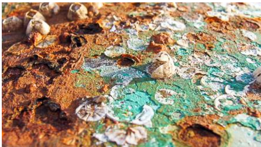
Fot. 4. Biokorozja metalu powodowana przez mikroorganizmy
