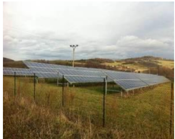
Fot. 2. Przykładowa naziemna instalacja fotowoltaiczna - rejon miejscowości Tremesna, Republika Czeska [fot. Krzysztof Kręciproch]
